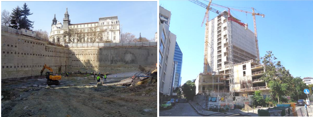
Фотоси 1 и 2. Състояние на строежа на сградата през м.02.2019г. (ляво) и сега (дясно)
