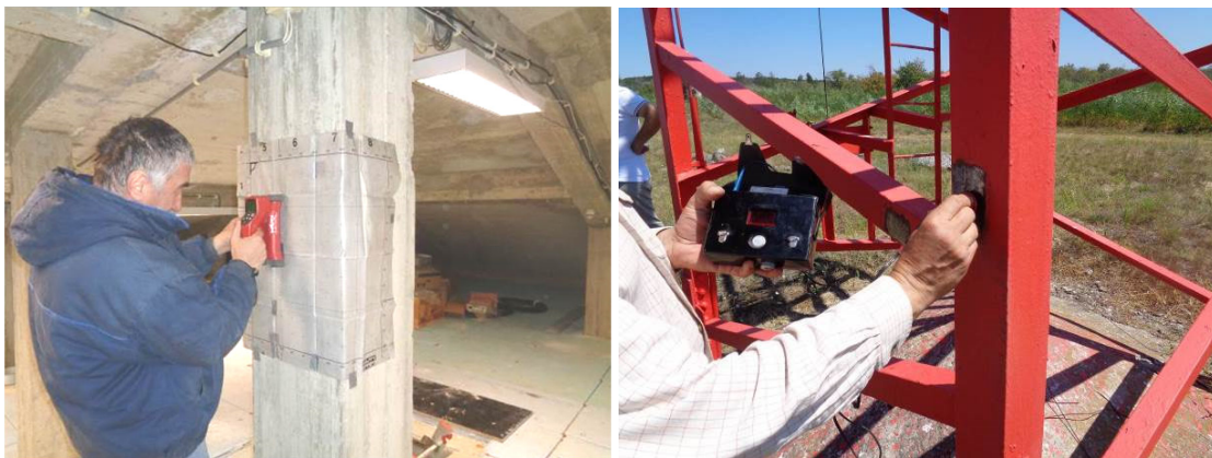
Фотоси 3.7 и 3.8 Диагностика на армировка (ляво) и изследване корозия на конструкционната стомана
