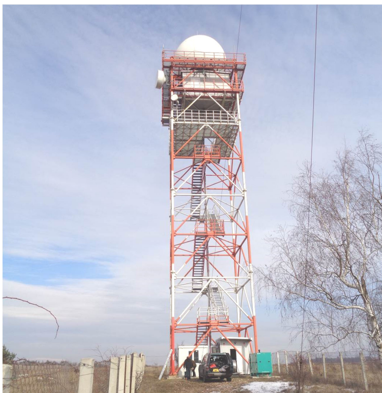
Фотос 2.3. Общ вид от юг към носещата конструкция и антенните системи на ДМРЛ София
