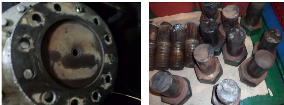
Фиг. 10. Дефектирали присъединителни фланци и болтове, м/к Hagen
