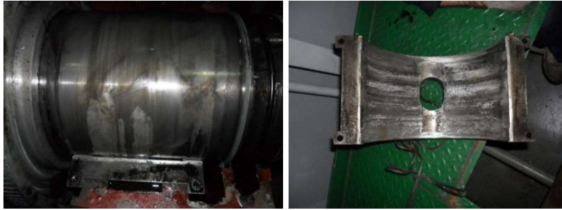
Фиг. 3. Разрушена лагерна композиция на опорния лагер на междинния вал на м/к Rease
