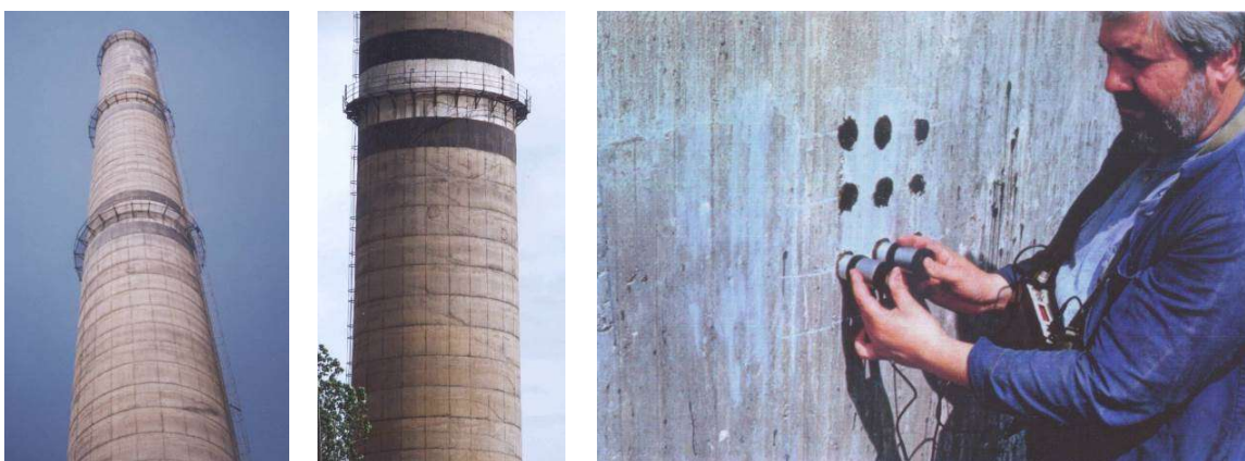
Фиг. 3.3, 3.4 и 3.5. Поглед отвън с фрагмент на комина на ТЕЦ „Видахим“ и момент от проведената ултразвукова диагностика на ст.б. тяло в участък с нарушена топлоизолация
