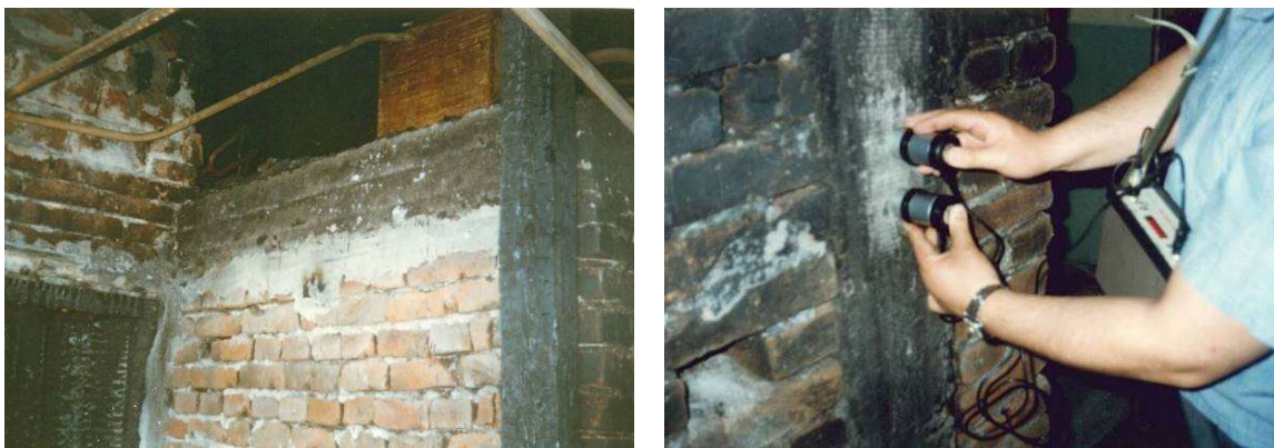
Фиг. 3.6 и 3.7. Поглед към част от конструкцията на жилищната сграда на ул. Крум Попов след пожара през пролетта на 1997г. и към една от прозвучаваните ст.б. колони
