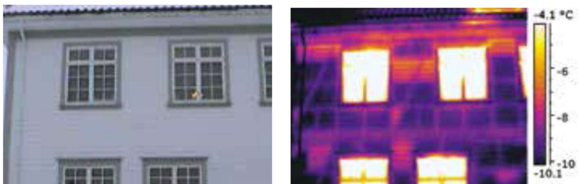
Фиг. 3 и 4 – Фотоснимка и термокартина на рамкова конструкция под външната топлоизолация
