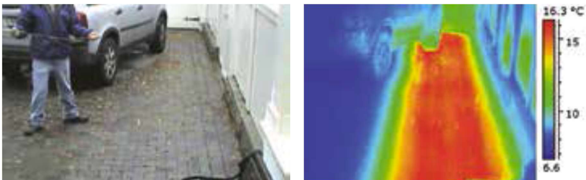
Фиг. 15 и 16 Външен вид и термокартина, показваща ясно дефект в централна улична отоплителна система
